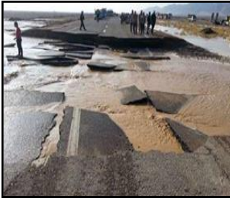
صورة رقم «١٤»: تدمير أحد الطرق الرئيسية برأس غارب نتيجة حدوث سيول
