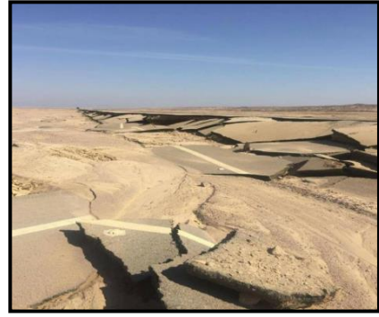
صورة رقم «١١»: تعرض الطرق لتشققات وخروج الطبقة الأسفلتية من عالية وحدث هبوط أرضي في بعض أجزاء
