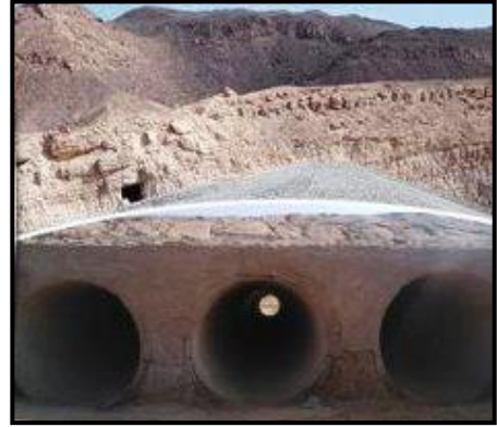
صورة رقم «٤»: المواسير أحد أشكال المعابر الأرضية أسفل الطرق بمنطقة غارب
