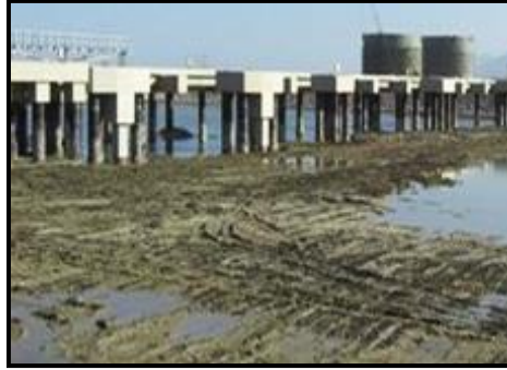
صورة رقم «١٠»: أثر ارتفاع منسوب المياه تحت سطحية على أساسات المباني بإحدى القرى السياحية
